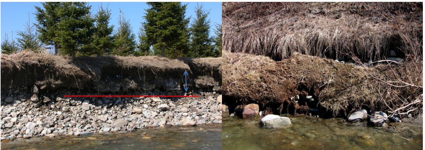
Figure 32: Effet de déstabilisation des glaces qui accentue l'érosion des berges
