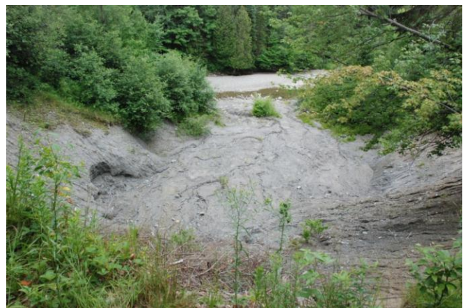
Vue du haut du talus de l'érosion
