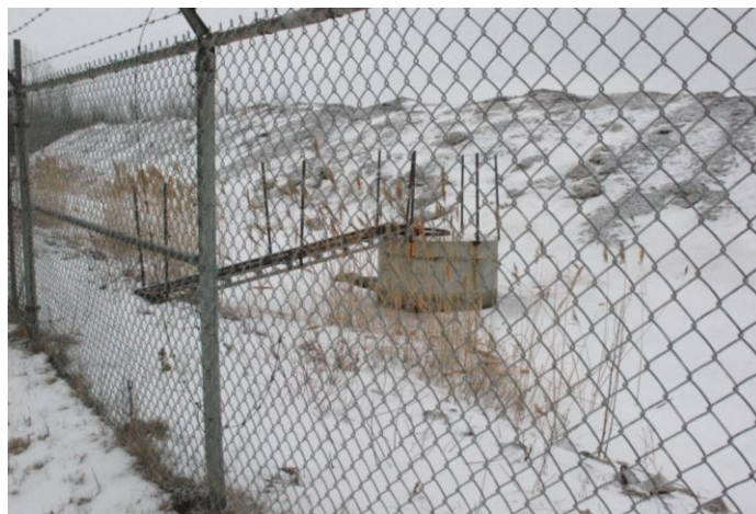
Puisard du réseau pluvial du dépôt à neige
