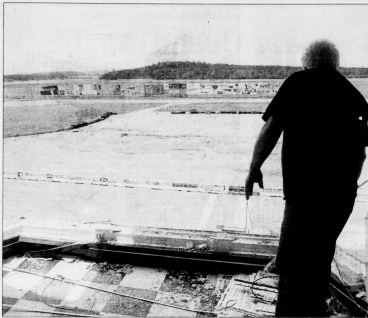
En raison de la destruction des fenêtres qui donnent directement sur un vide d'une trentaine de pieds, l'édifice de l'Autodrome constitue un danger public pour qui se rendrait sur place.
