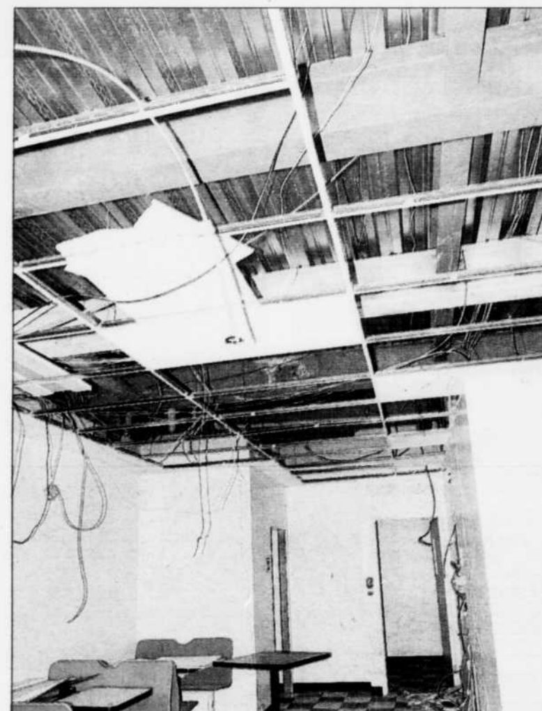
Les vandales ont même attaqué les murs et le plafond de l'édifice.
