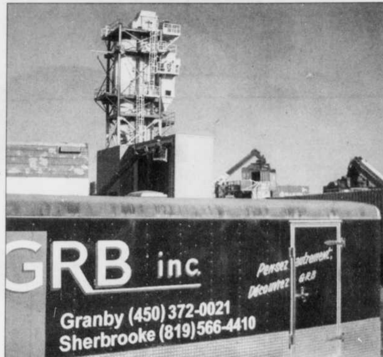
Finition du poste de transbordement de grain de Transport Ray-Mont à Montréal.
