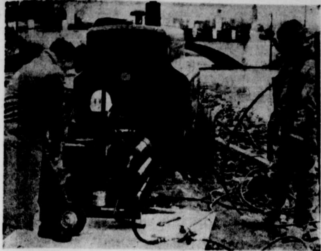
DES QUE LE MOTEUR de ce compresseur sera en marche, ce travailleur sous-marin à l'emploi d'Aqua Construction descendra dans les eaux de la rivière St-Maurice pour des travaux préparatoires à la coulée des piliers du pont de Shawinigan.
