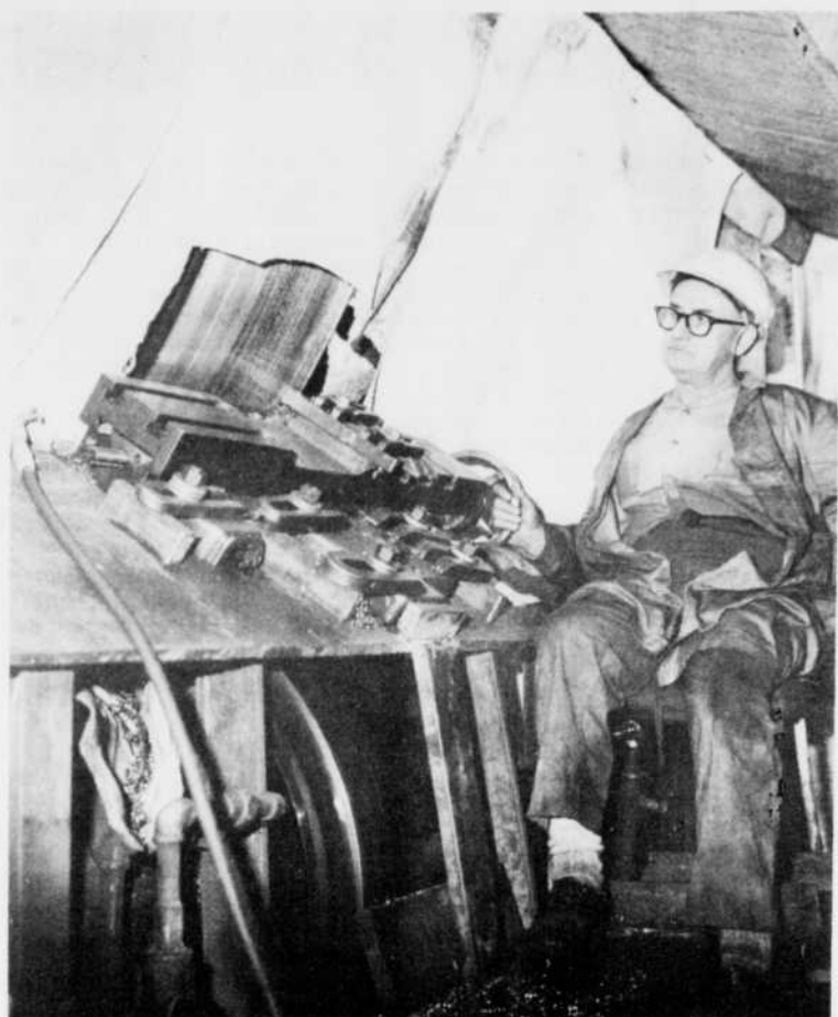
LA première opération consistait à enlever les excès de soudure à l'aide d'un couteau à métal monté sur une table de tour à métal, modifiée pour s'adapter à la structure du four. M. Georges-Edouard Savard, machiniste, responsable du projet, surveille le tournage du bandage.
