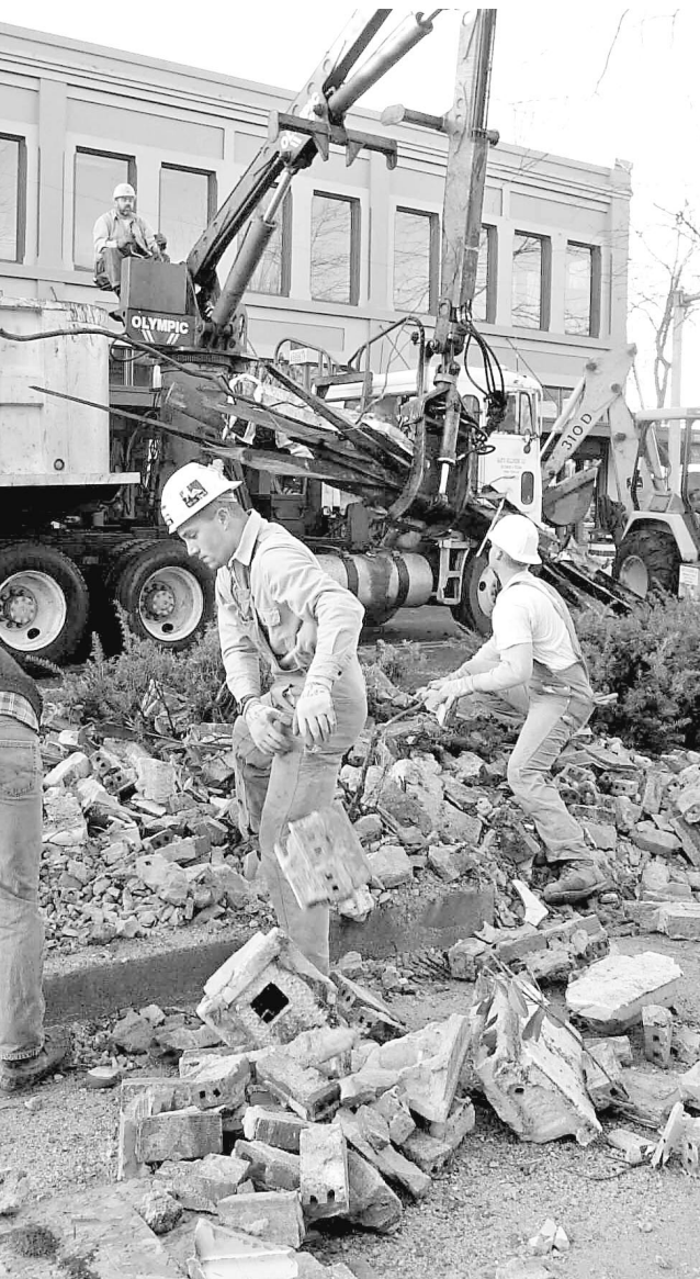
Des ouvriers s'affairaient hier à dégager les débris jonchant le centre d'Olympia, capitale de l'État de Washington.
