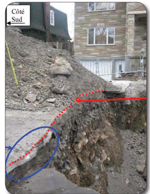
Cicatrice de rupture de la paroi sud (CSST)
