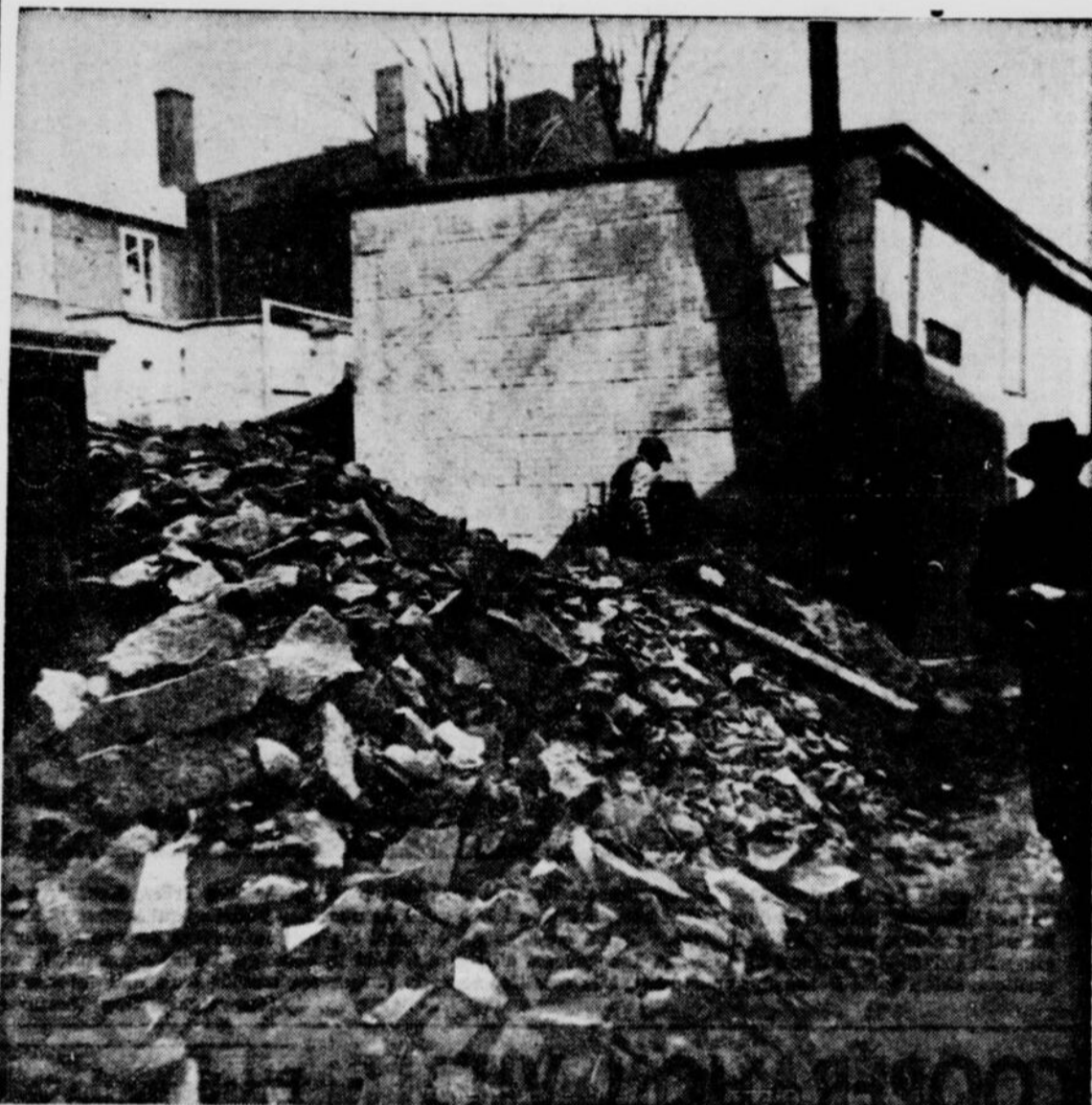
Voici l'aspect que présentaient les débris d'un épais mur de ciment en construction qui s'écroula, hier après-midi, en arrière du no 3436, rue St-Denis, où l'on était à construire un garage. Trois ouvriers furent blessés lors de cet éboulement, dont l'un assez grièvement.
