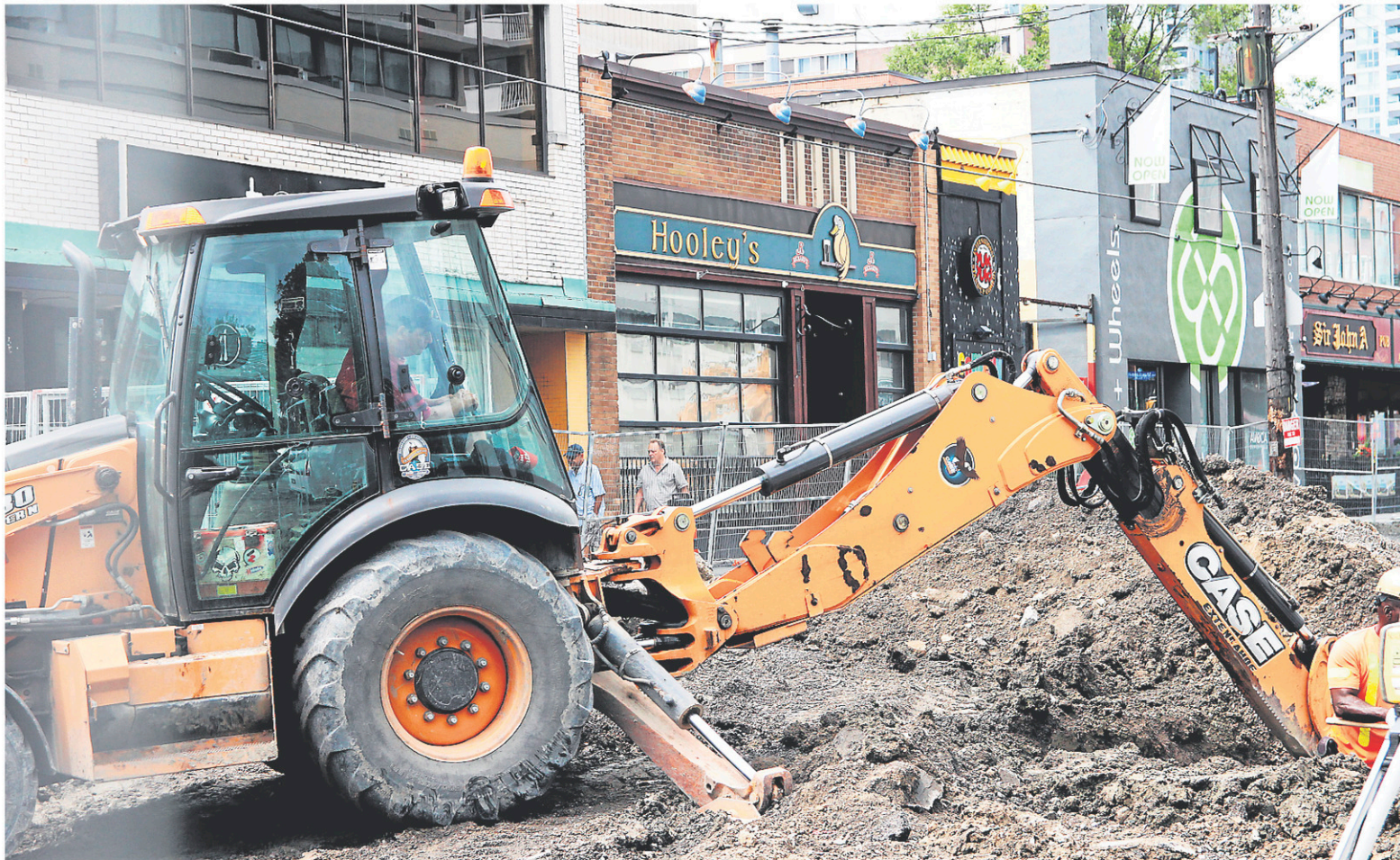
Les travaux de construction sur la rue Elgin ont eu raison du Hooley's. — ÉTIENNE RANGER, LE DROIT
