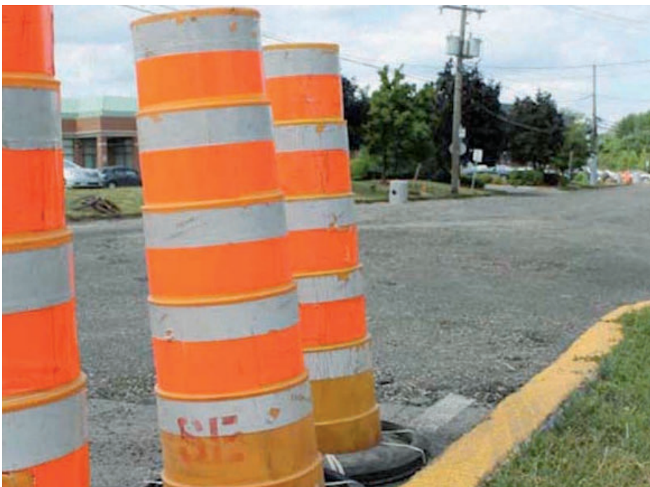
La Ville de Saint-Eustache amorcera, le 21 août, la phase deux des travaux sur le boulevard Industriel.
