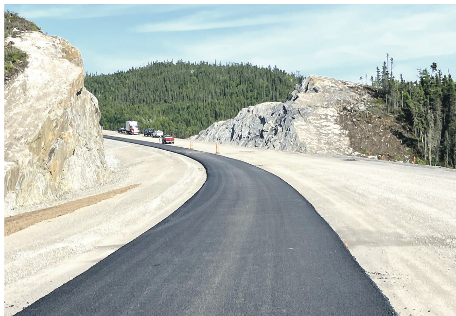
La nouvelle route asphaltée de la côte Bellevue en direction est. Photo courtoise
