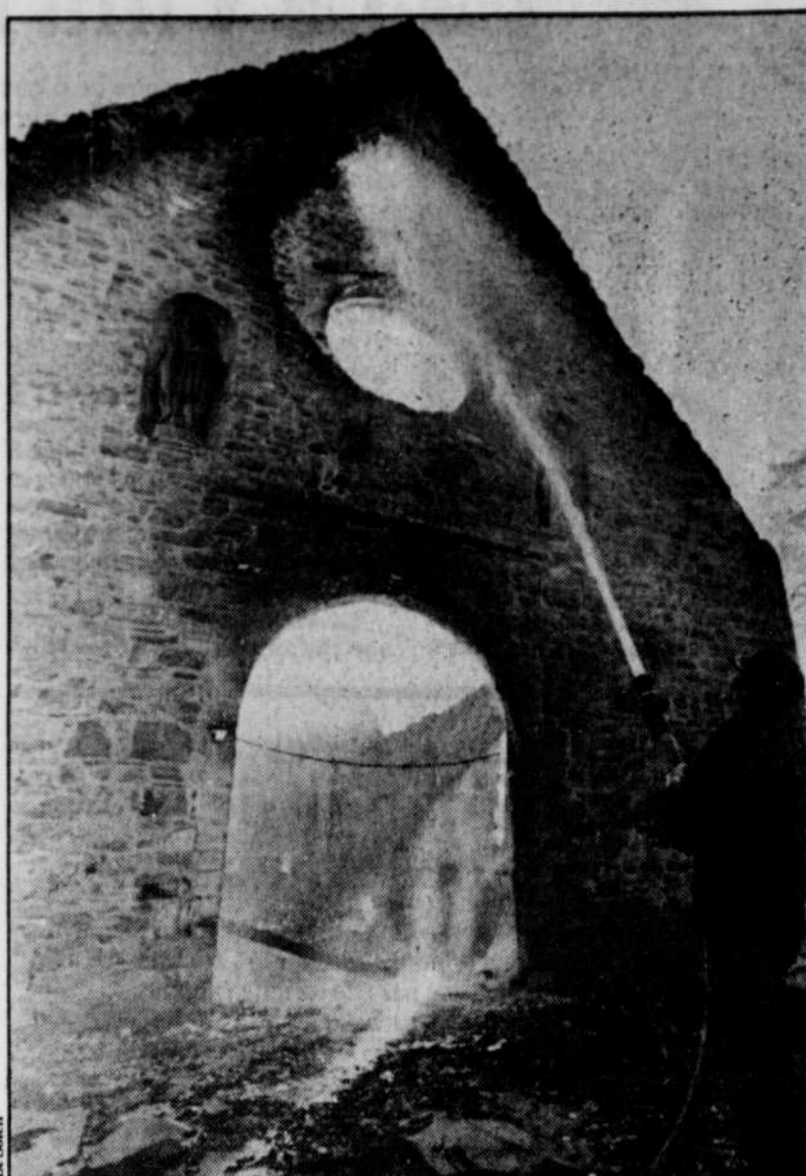
L'église historique de Saint-François de l'île d'Orléans a été détruite par les flammes au début de juin 1988. Seuls les murs de pierre ont résisté.
