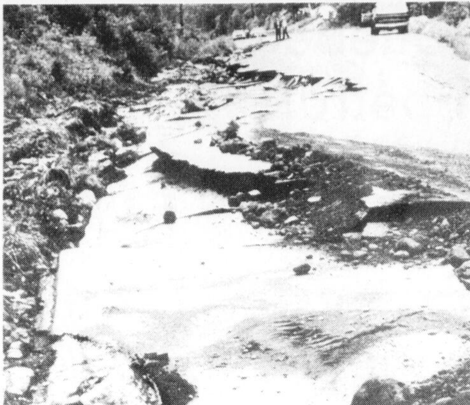
ROUTE ACCIDENTÉE — Des équipes du ministère des Transports du Québec constatent l'importance de la tâche de réparer des douzaines de routes dans la région des Laurentides au nord de Montréal par suite d'une fin de semaine d'inondations éclair. Des dommages comme ceux-ci à la route 370 entre Sainte-Adèle et l'Estrel ont forcé la fermeture de plusieurs routes.
