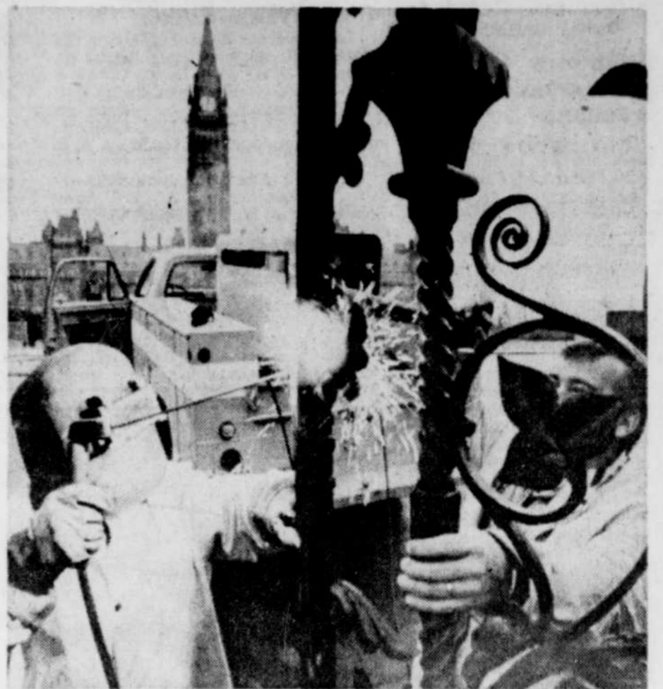
Un ouvrier fait quelques retouches à l'une des grilles devant le Parlement d'Ottawa, quelques heures avant l'arrivée de la reine.
