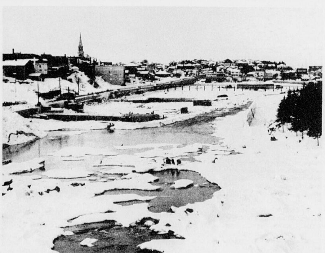
LA MUNICIPALITE D'ALMA effectue présentement des travaux d'hiver pour plusieurs milliers de dollars dans la Décharge. Ces travaux consistent dans la construction de deux estacades et d'un bassin autour de la fontaine. On a ici une vue des travaux du pont Carcajou.
