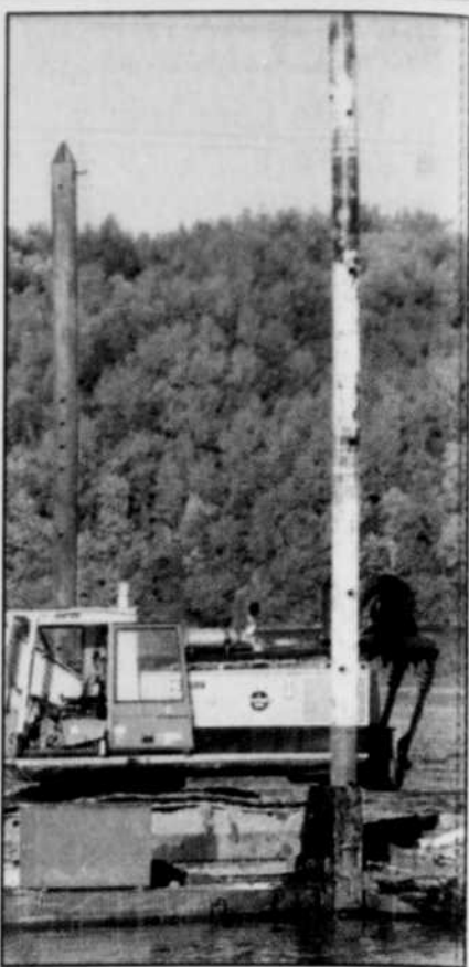
(Photo - Sylvain Mayer) C'est avec ce bateau que les ouvriers de l'entreprise Gaston Morin ont accidentellement sectionné le câble électrique.
