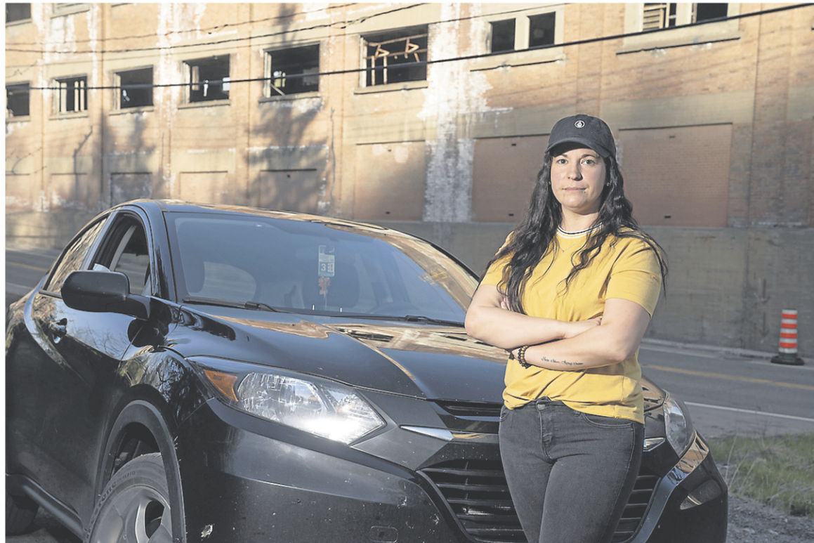
Audrey Sanscartier craint pour la sécurité des automobilistes qui circulent sur le boulevard Pie-XII à Shawinigan, où le mur de l'ancienne usine Belgo longe la voie. — PHOTO: STÉPHANE LESSARD
