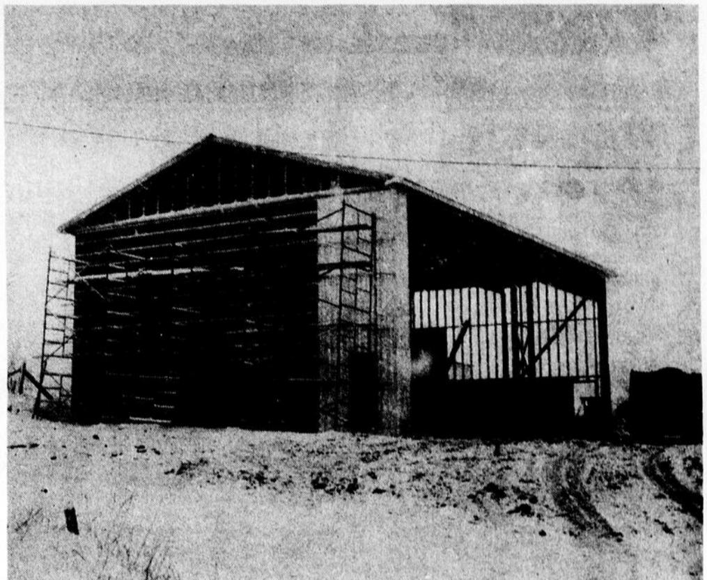
Cette bâtisse abritera les deux séchoirs à bois de l'entreprise Les Préparations de Bois Aubé Inc., située sur le Chemin de la Normandie à Montmagny. Les séchoirs devraient entrer en fonction vers la mi-décembre.
