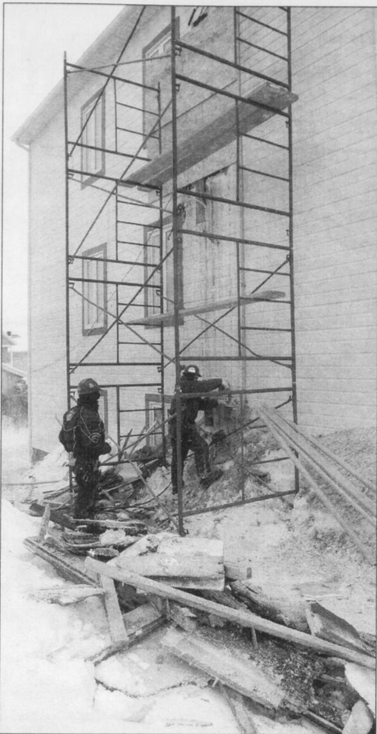
MÂT - C'est un court-circuit dans le mât extérieur de l'entrée électrique qui a causé l'incendie dans cette maison de la rue Victoria à La Baie. (Photo Rocket Lavoie)
