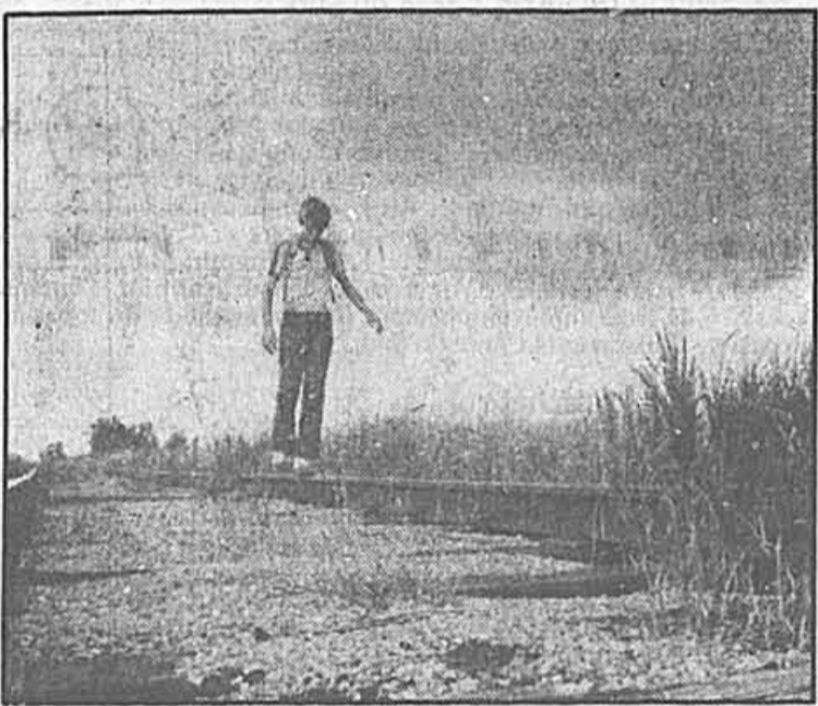
Le CN soutient que 17 000 des 47 000 km de voies ferrées sont sous-utilisées et qu'il faudrait en couper. PHOTO D'ARCHIVES
