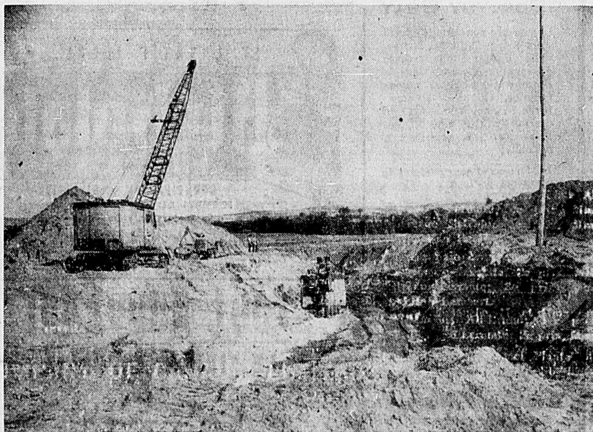
D'importants travaux publics sont présentement en cours dans la partie ouest de la ville de Victoriaville. On voit ici deux pelles mécaniques qui travaillent à la pose de l'égoût collecteur qui se déverse dans la rivière Nicolet en face du Parc Grenier. (Photo Bourret)
