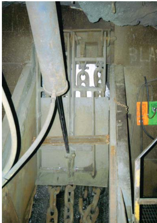
Figure 4.4. Rideau de chaînes de contrôle dans une chute, méthode d'action directe par un poussoir.
