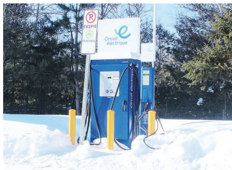
La station de recharge du restaurant Le Chavigny à Deschambault-Grondines est la plus utilisée du Circuit électrique d'Hydro-Québec dans la Capitale-Nationale. PHOTO - ARCHIVE
