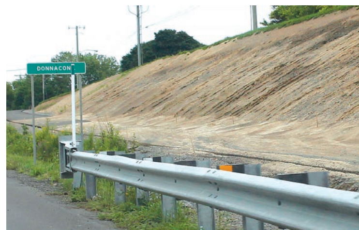
Les fortes pluies des dernières semaines ont retardé l'ensemencement et miné le talus. PHOTO - DENISE PAQUIN
