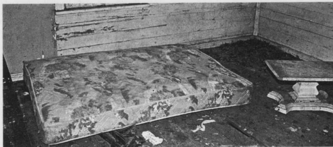
CHAMBRE - Voici une des pièces de l'étage où un matelas couvert d'excréments et d'urine d'animaux était étendu par terre. On ne sait pas s'il était utilisé par les résidents des lieux.
