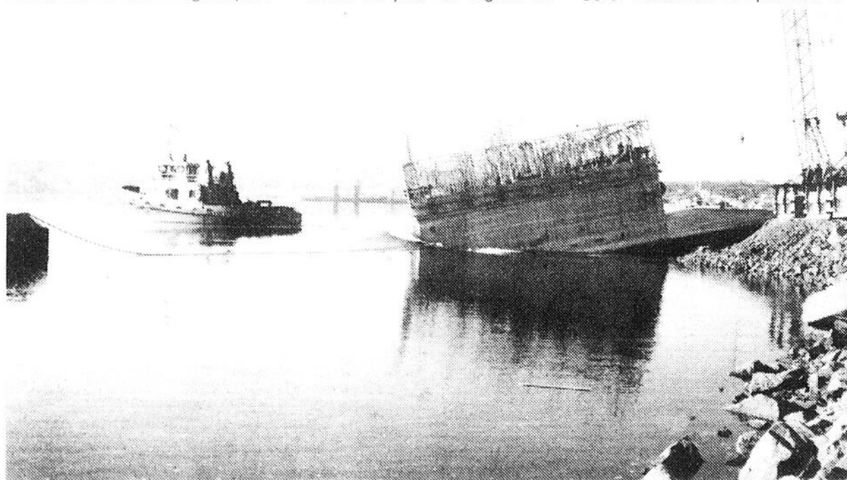
Mise à l'eau et transport par flottage d'un caisson du quai de Grande Anse.
