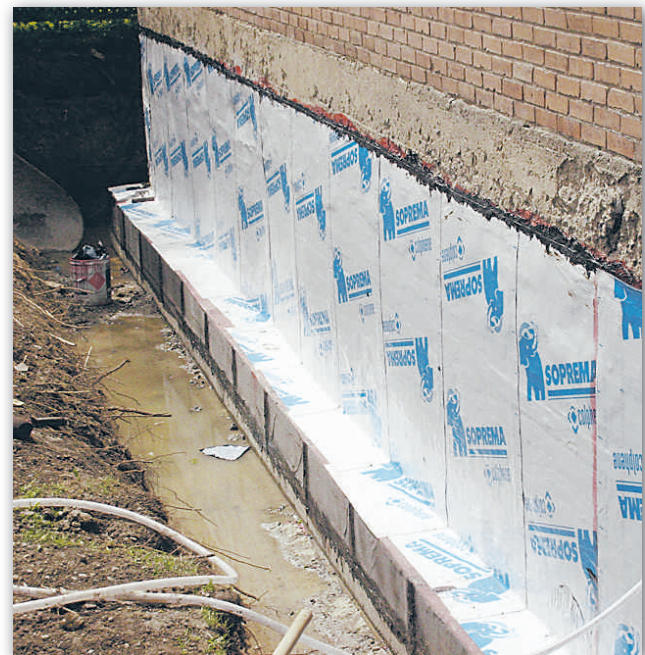
Après avoir ressemelé les fondations, les experts de Drainaco ont installé une membrane d'étanchéité afin de les imperméabiliser.
