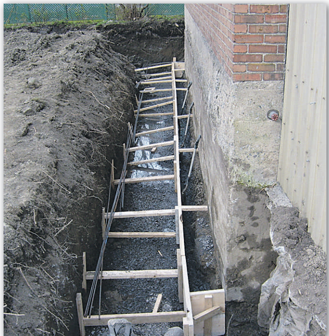
On constate, à certains endroits, l'absence de la semelle d'assise, ce qui entraîne une infiltration d'eau.
