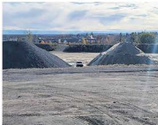
Un périmètre de sécurité a été érigé sur le site des matériaux secs au bout de la rue Filion.
