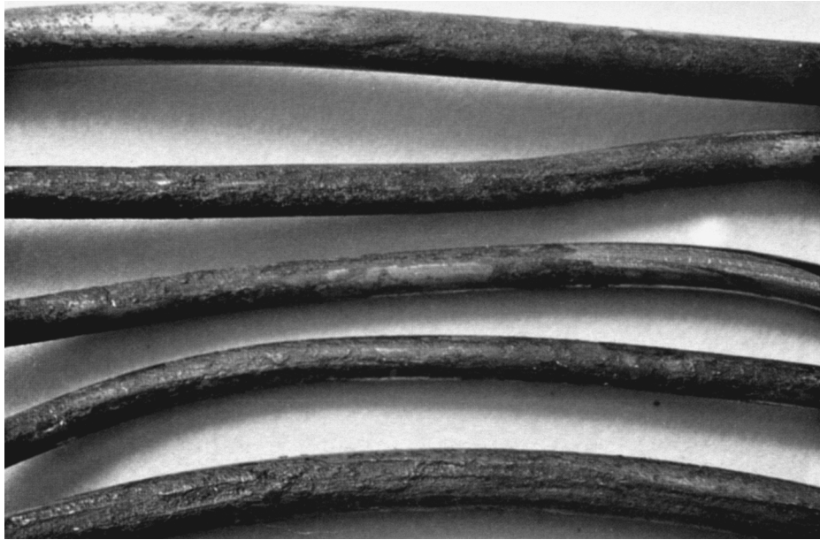
Figure A.4 — Légère corrosion
