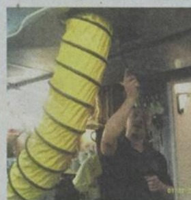
Avec ce capteur de poussière, on aspire littéralement toutes les saletés qui se trouvent à l'intérieur du conduit.
