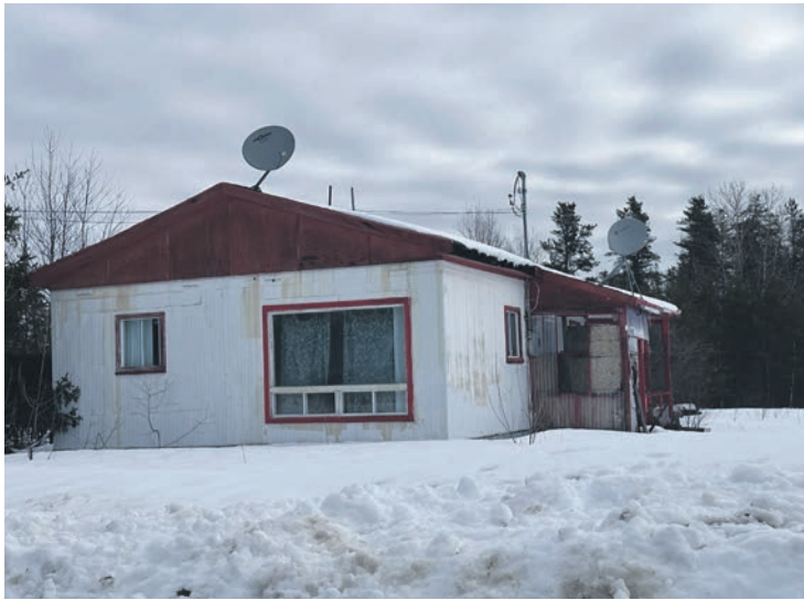
La maison du 254, 9 e rue est en état de décrépitude avancée. Photo Johannie Gaudreault
