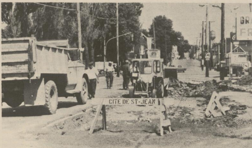
LES TRAVAUX de reconstruction et d'élargissement de la rue Saint-Jacques, à Saint-Jean, ont repris hier matin. Ces travaux, comme on le sait, avaient été suspendus par suite de l'arrêt de travail chez les ouvriers syndiqués. Les autorités municipales de Saint-Jean ont bon espoir qu'ils seront complétés au cours des prochaines semaines. (Photo: Studio Brouillette)
