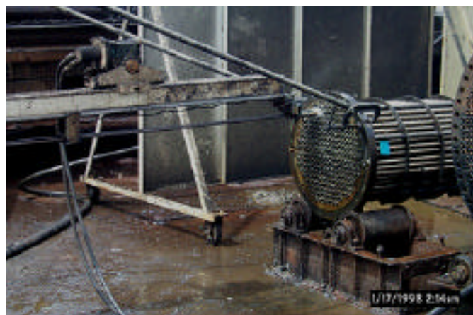
Figure 17: Tête d'une machine de nettoyage à distance utilisée pour l'intérieur d'un échangeur
