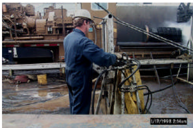
Figure 16: Poste de l'opérateur d'une machine de nettoyage à distance
