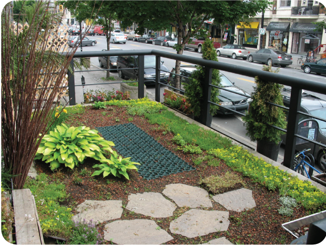
Image 4- Système MODI Roof Garden en démonstration chez Toits vertige
