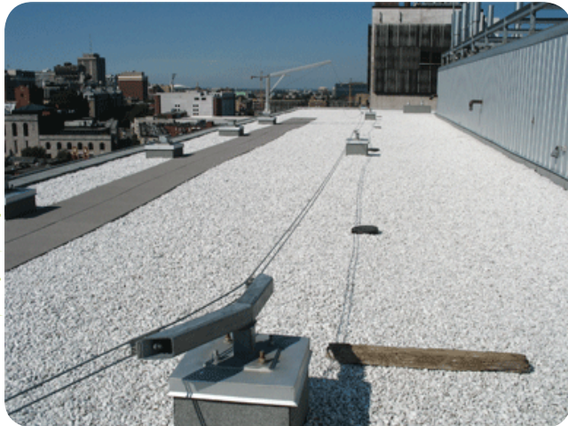
Image 16- Toiture inversée avec ballast blanc réfléchissant (Hydrotech) sur le pavillon des sciences biologiques à l'UQAM- Membrane en polyoléfine thermoplastique (TPO)
