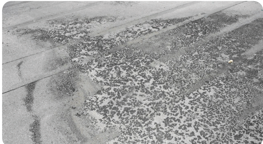
Image 18- Désagrégation d'une membrane élastomère à base de bitume de 10 ans d'âge
