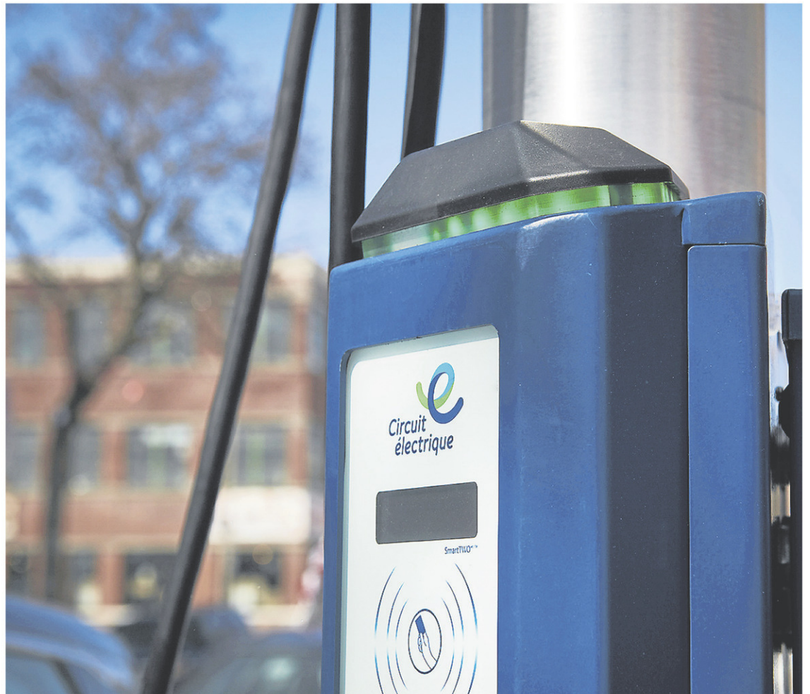
Les investissements du gouvernement fédéral contribueront sûrement à déployer de plus en plus de bornes de recharge sur rue de niveau 2 dans les quartiers centraux. — PHOTO HYDRO-QUÉBEC
