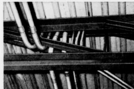
LES TUYAUX DE PETITS DIAMÈTRES réservés aux services d'oxygène, d'aspiration et d'électricité passent facilement à travers les semelles supérieures à angles doubles espacés dans les divisions, sans cintrages ou retraits.
