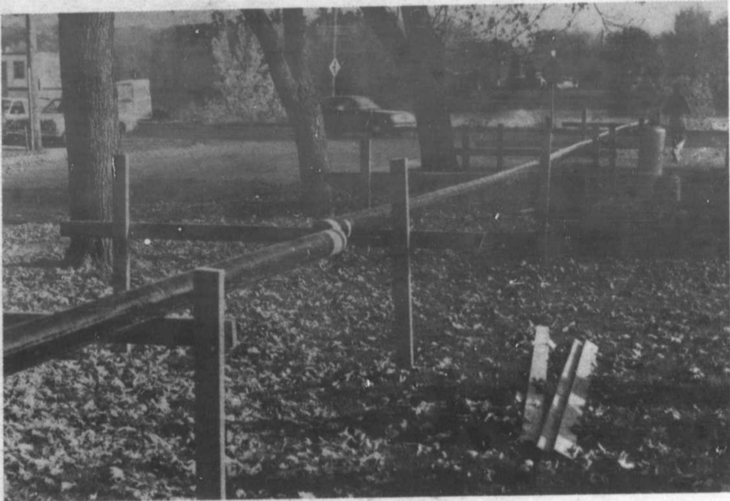
Ces nouveaux conduits électriques entre McMasterville et Otterburn Park sont nécessaires pour répondre aux besoins en énergie électrique des abonnés de Saint-Hilaire et Otterburn Park. Dès 1981, une partie de Beloeil sera aussi alimentée par ces conduits. [Photo: Candide Caméras].
