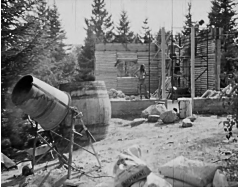
Construction de L'Abri d'Érasme à Sainte-Agathe-des-Monts. (Image tirée du film L'interdit de Pierre Maheu).
