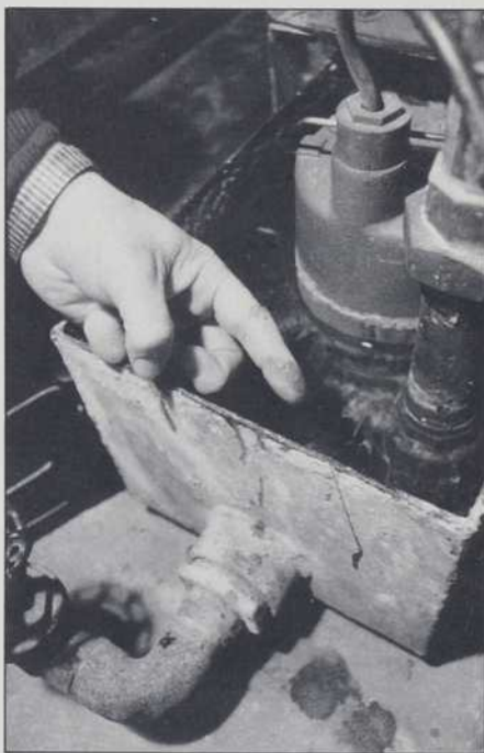
Le mauvais entretien des installations peut contribuer à l'éclosion de micro-organismes qui voyagent dans les conduites d'air. Ici, l'eau d'humidification est contaminée par des bactéries.
