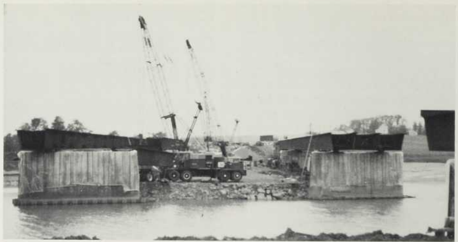
Les poutres-caissons du type "baignoire" ont été mises en place sur les piles par des grues mobiles.
