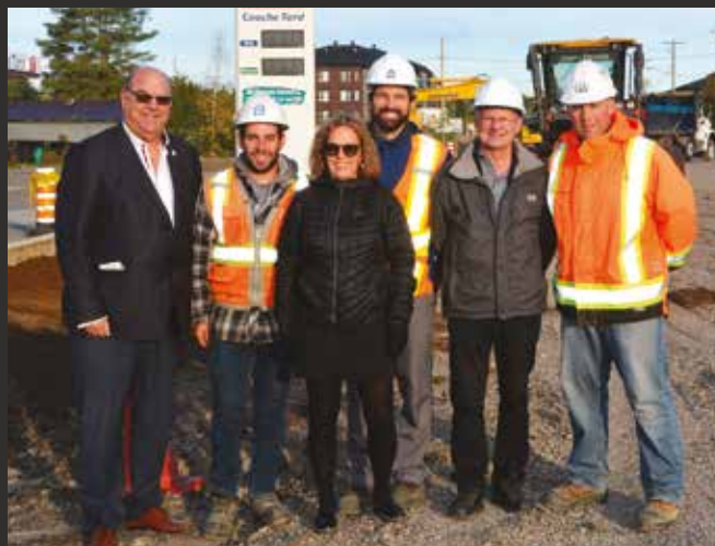
Ici réunis lors des premiers coups de pelle : Claude Crépeau (directeur général de la Ville), Maxime Généreux (Les Entreprises Généreux), Chantal Riopel (conseillère municipale), Jonathan Marion (directeur des services techniques), le maire Robert Bibeau et André-Philippe Cantin (GBI).
