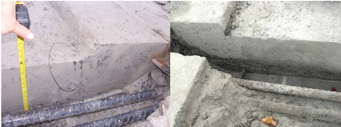
Figure 6.2 – Fissure le long des suspentes dans la fenêtre centre-ouest (gauche : face nord et droite : face sud)
