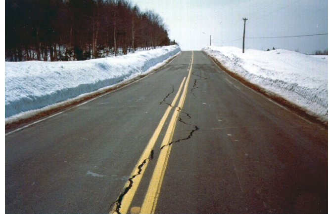
Fissure longitudinale, telle que décrite à la figure 2
