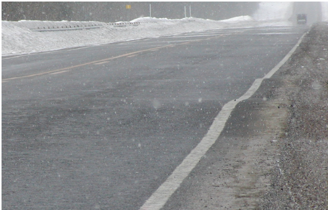
La chaussée ci-dessus présente un soulèvement de 20 cm.
