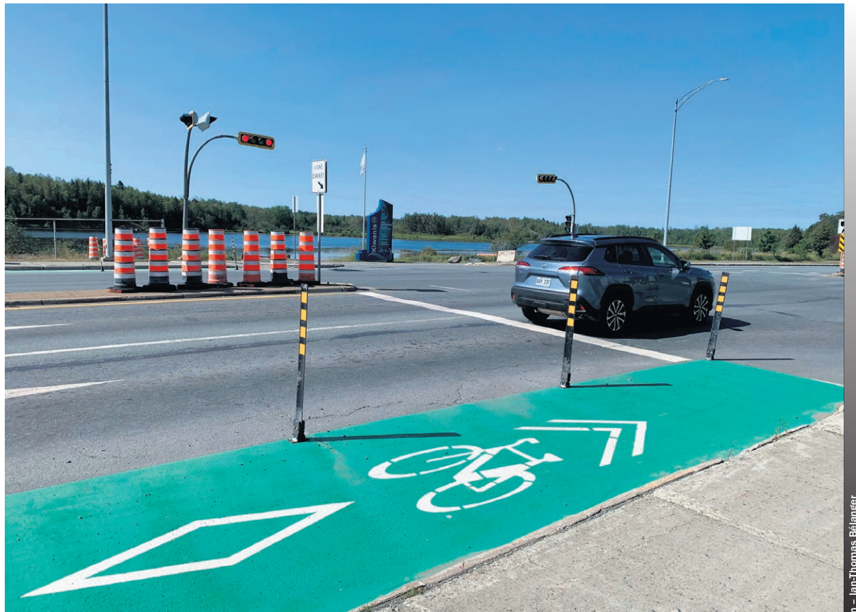
La Ville de Rouyn-Noranda consacre 1.5 million de dollars dans la réfection de l'intersection de la 15 e rue et du boulevard Rideau afin de rendre les lieux plus sécuritaires.
