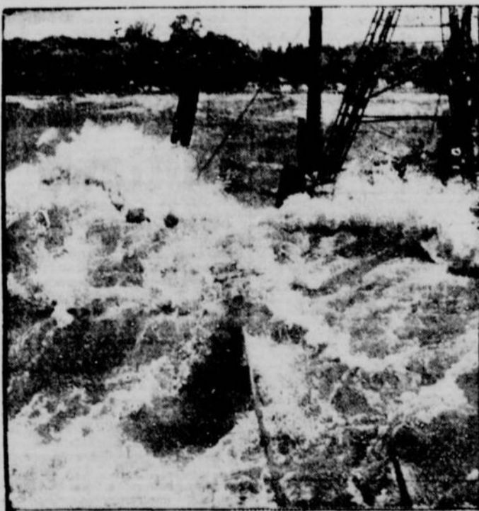
Dans la tempête de fin de semaine, le quai en construction à Leamington a été emporté par l'eau et une drague de $60,000 a coulé à pic.
