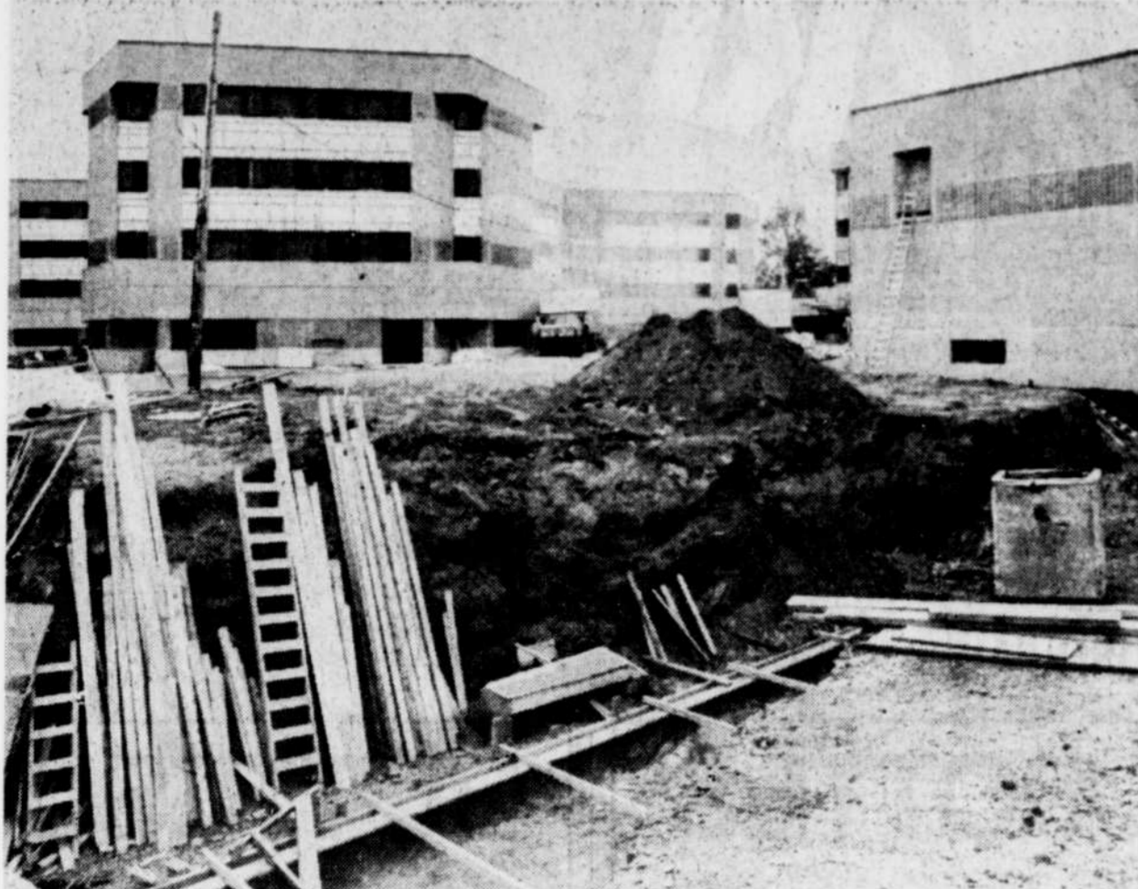
Plusieurs locaux ne seront pas prêts pour la rentrée.
