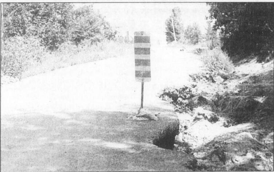
Depuis près de trois mois, les véhicules qui empruntent le rang Saint-Patrice zigzaguent entre les trous.
