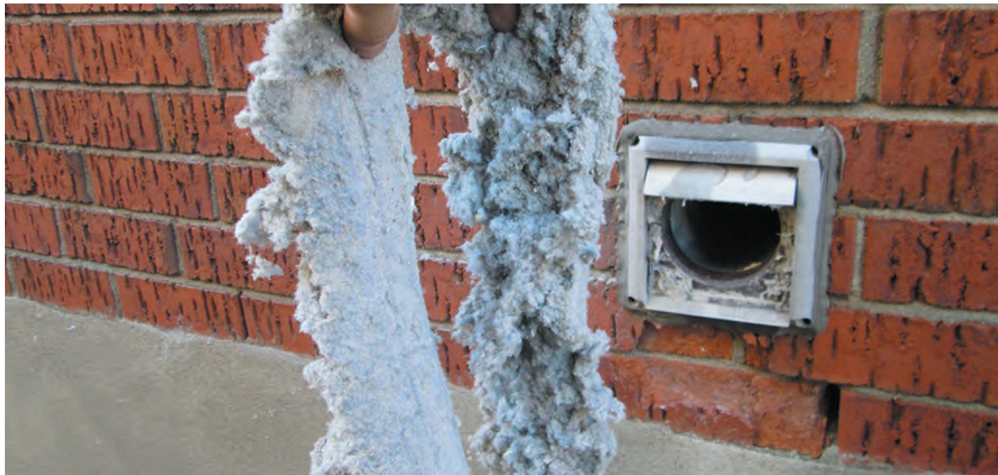
La charpie ne se retrouve pas uniquement dans le filtre que vous videz à la fin de chaque cycle de sècheuse, mais bien souvent dans les conduits.
