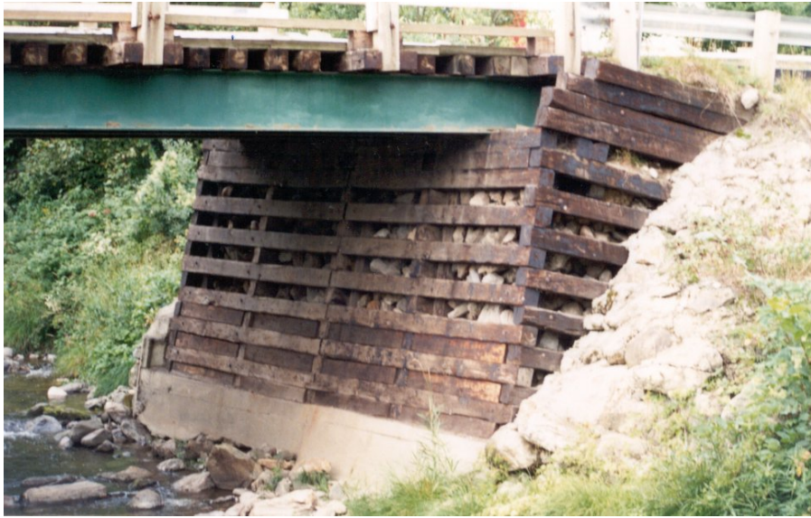
Photo 2.4-7 – Mouvement de fondation qui affecte le comportement du caisson
