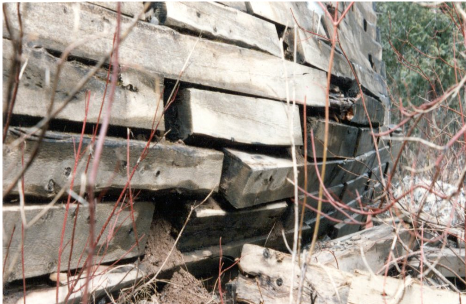
Photo 2.4-8 – Bombement très important d'un caisson
