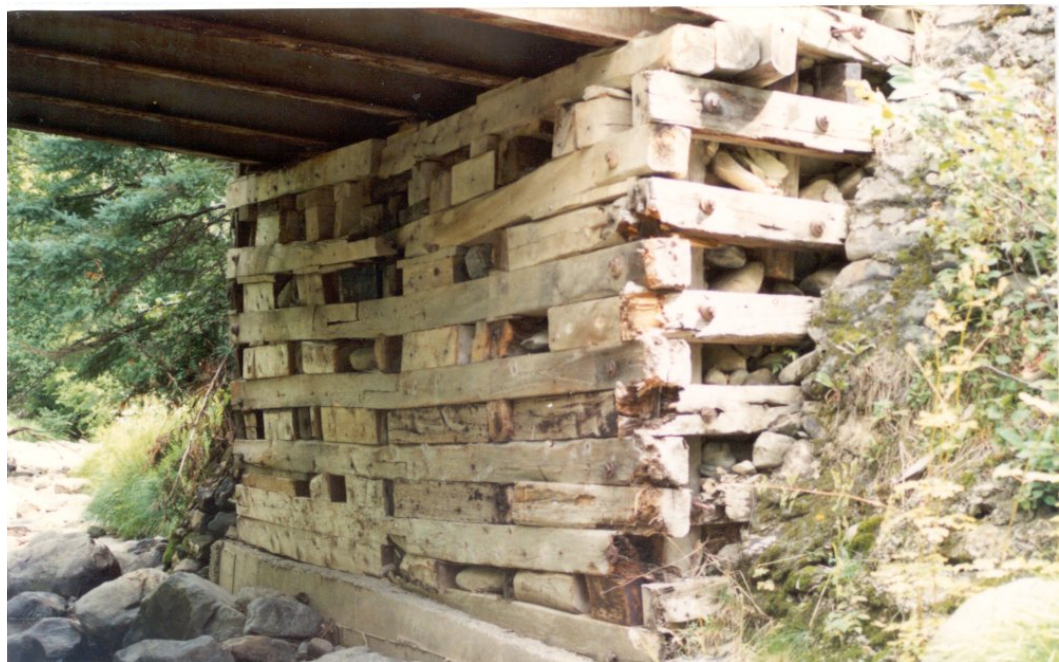
Photo 2.4-6 – Pourriture importante d'un caisson
