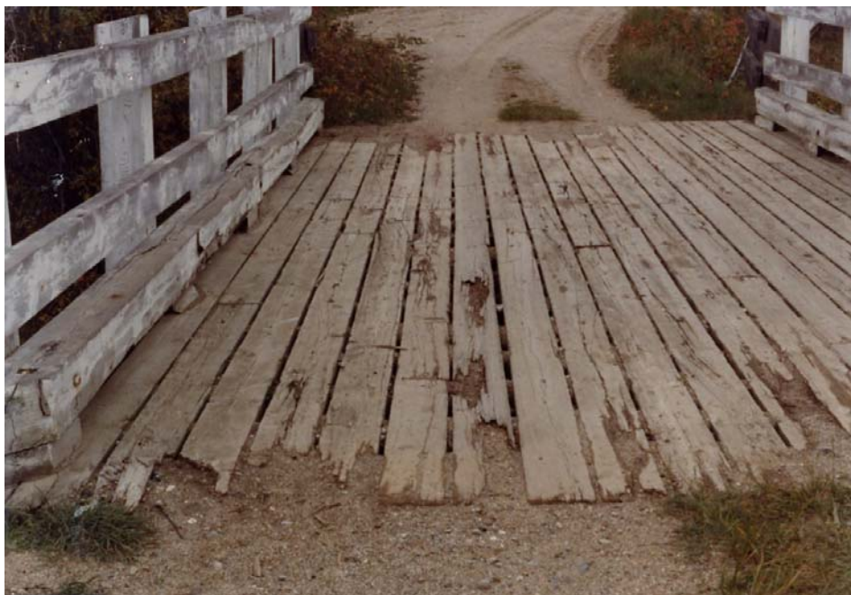
Photo 2.4-10– Pourriture importante d'un plancher
