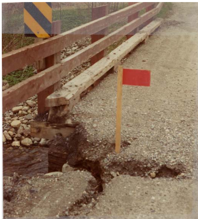
Photo 2.4-12– Érosion de l'accotement à l'approche
