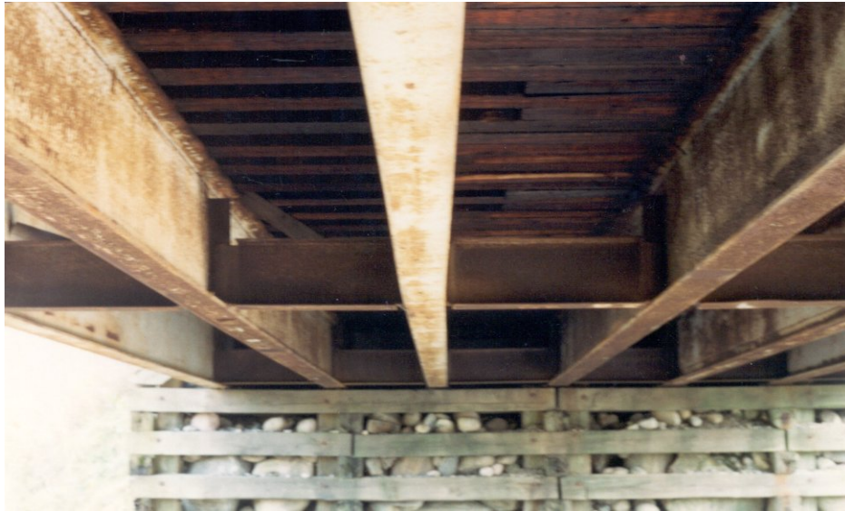
Photo 2.4-9 – Position inadéquate des diaphragmes par rapport à la semelle comprimée
