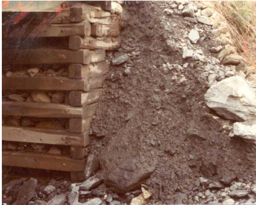
Photo 2.4-5 – Perte de matériaux affectant de façon importante le comportement du remblai
