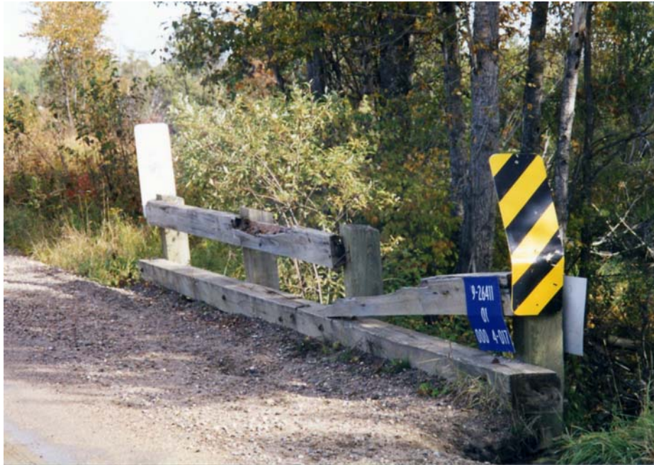
Photo 2.4-11– Défauts de glissière affectant la sécurité des usagers
