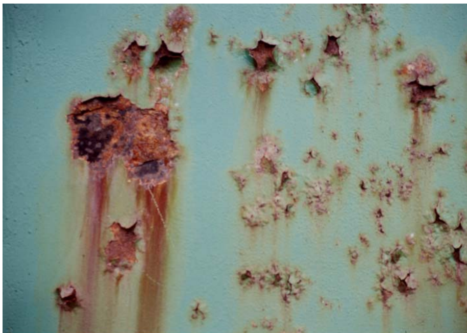
Photo 2.4-4 – Corrosion sous le feuil de peinture
