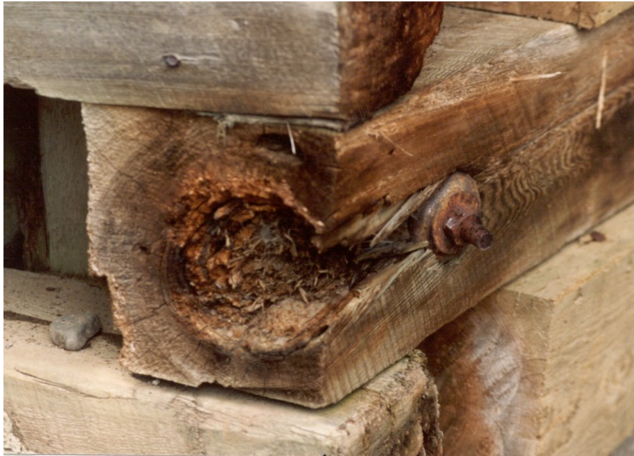
Photo 2.4-3 – Pourriture importante de l'extrémité d'une pièce de caisson
