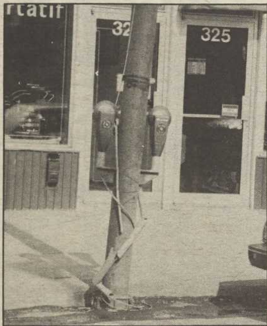
Les anciens poteaux métalliques de la rue Principale présentent un aspect inquiétant témoignant de vices profonds.
