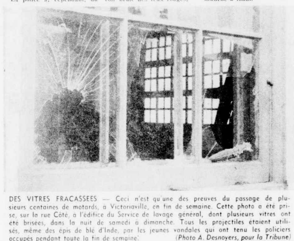
DES VITRES FRACASSEES — Ceci n'est qu'un des preuves du passage de plusieurs centaines de motards, à Victoriaville, en fin de semaine. Cette photo a été prise, sur la rue Côté, à l'édifice du Service de lavage général, dont plusieurs vitres ont été brisées, dans la nuit de samedi à dimanche.
